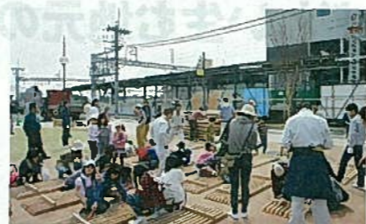
写真4 ■ 東口駅前広場で線路沿いの境界柵には近隣エリアの特産材「八女杉」を使い、地元小学生などが組み立てた(写真:柳川市)
